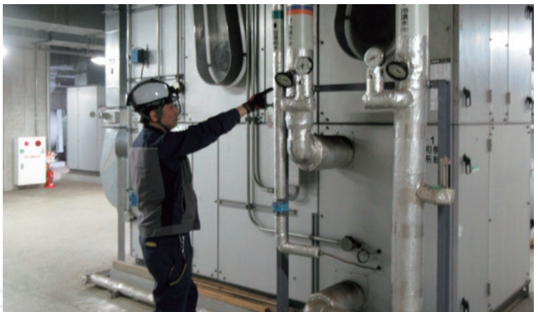
空調設備の保守点検 ▶
