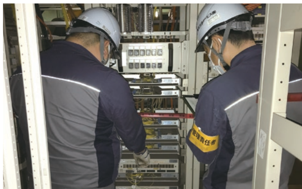
▲ 携帯電話設備の保守立会
