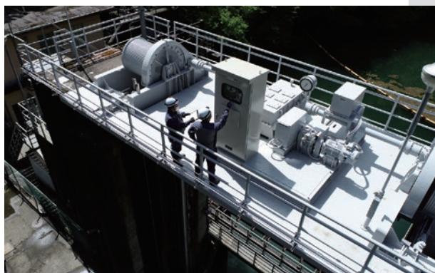
▲ 発電設備の保守点検
