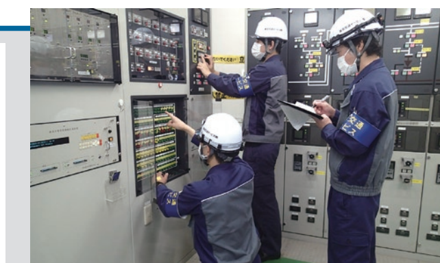
▲ 変電設備の保守点検
