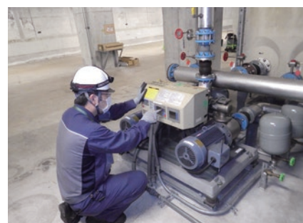
ポンプの保守点検
